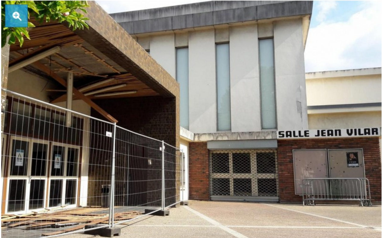
Argenteuil. Une partie du plafond du auvent de la salle Jean-Vilar s'est récemment effondrée. Un autre incident était survenu en mars dans cette salle. LP/Marjorie Lenhardt
