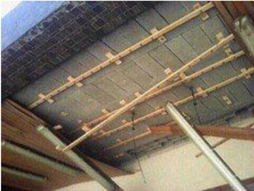
Argenteuil, ce jeudi 28 juin 2018. matin, L'état de la salle des fêtes Jean Vilar se dégrade: une partie notable de la garniture de l'auvent de l'entrée s'est effondrée, entraînant une chute de parpaings du toit. DR
